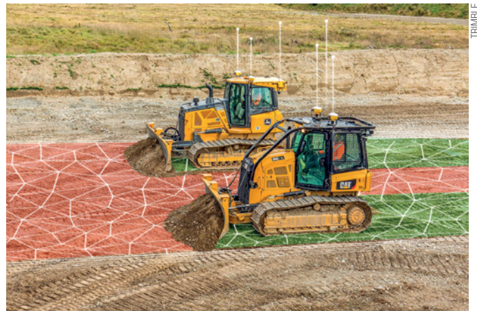
O sistema Trimble Earthworks integrou a ampla oferta tecnológica exibida pela marca no evento
